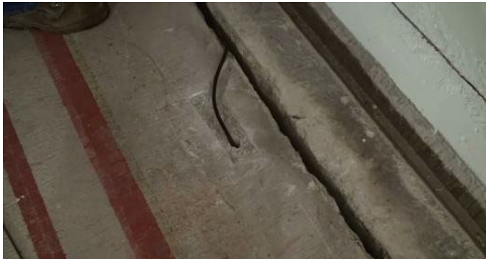
Figure A7. Moisture sensor.
