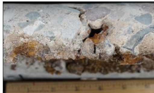
(d) Corrosion penetrating the lower core concrete
