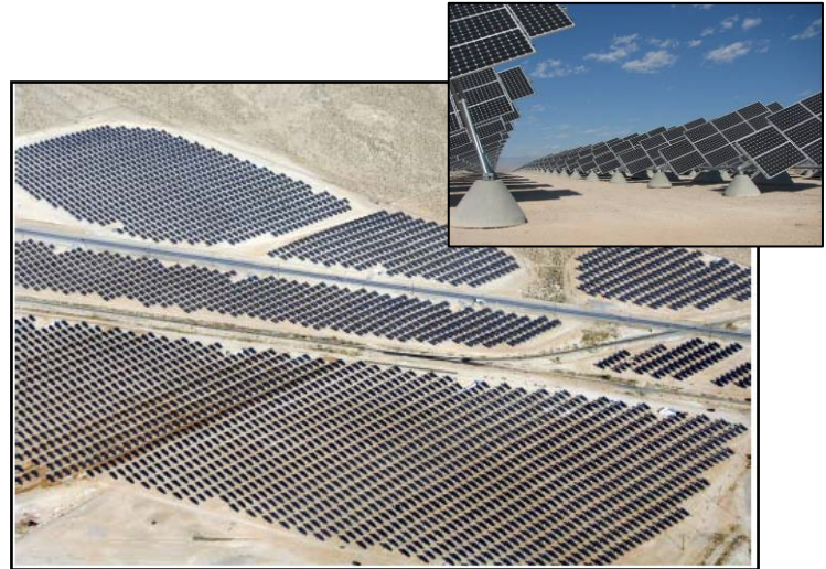
Fig. 8. Nellis Air Force Base solar array
