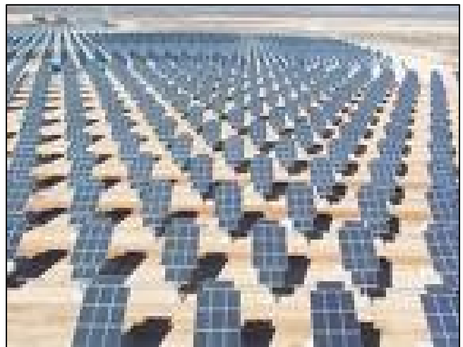
Fig. 5. Nellis Air Force Base solar array
