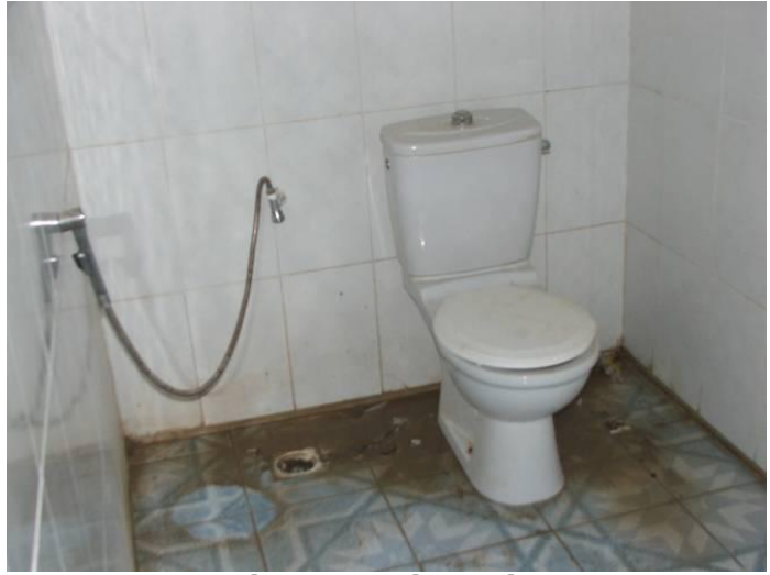
Site Photo 23. Leaking toilet
