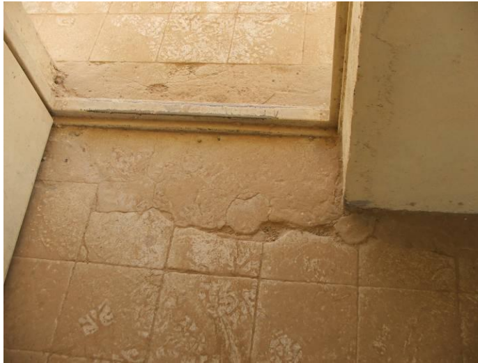
Site Photo 7. Uneven floors
