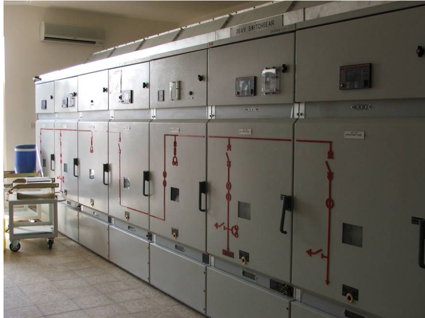
Site Photo 3: 33 kV Switchgear
